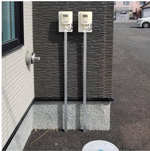
メーターポール（受信器設置専用ポール）
